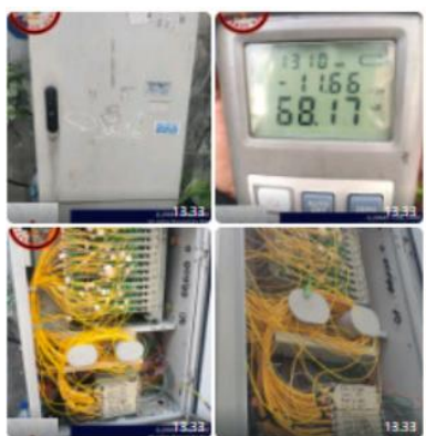
Gambar 7. Hasil pengukuran dengan optical power meter di ODC dan di FAT
