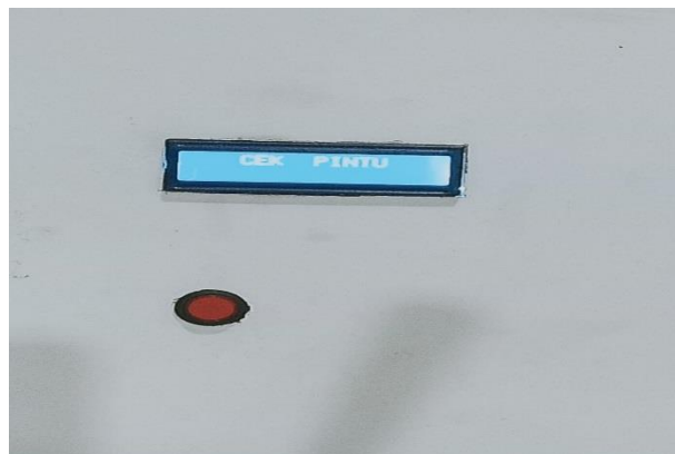
Gambar 14. Posisi Pintu Tidak Tertutup
